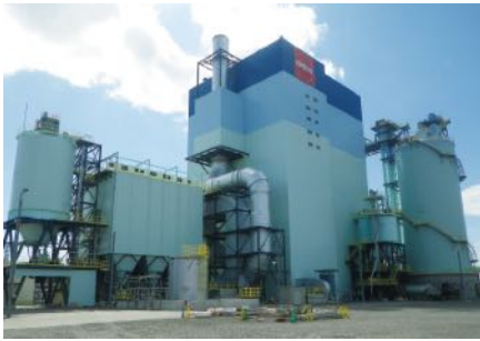
室蘭バイオマス発電所
