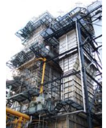
排煙脱硫装置
