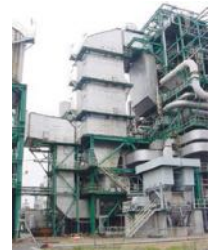
排煙脱硝装置
