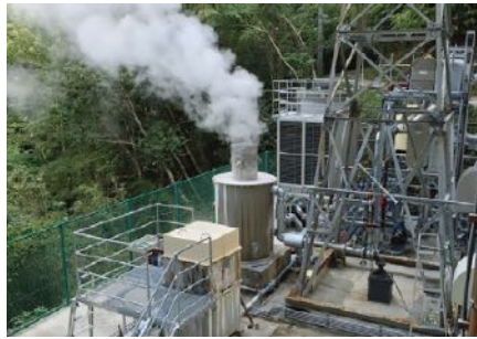
下田温泉バイナリー発電所
